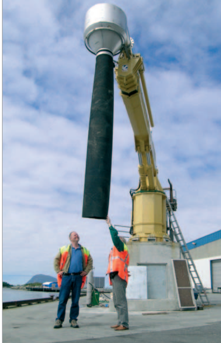
Pneumatisk lastesystem med kapasitet 100 tonn i timen
